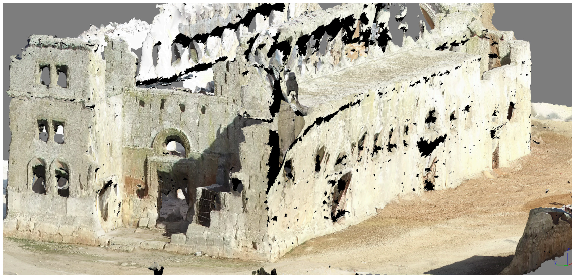
الشكل ٢٤: زوم مكبّر للكنيسة من جهة الجنوب الغربي (نموذج تم إعداده بواسطة طائرة بدون طيار)، نلاحظ انحراف جزء من الجدار الجنوبي بشدة
